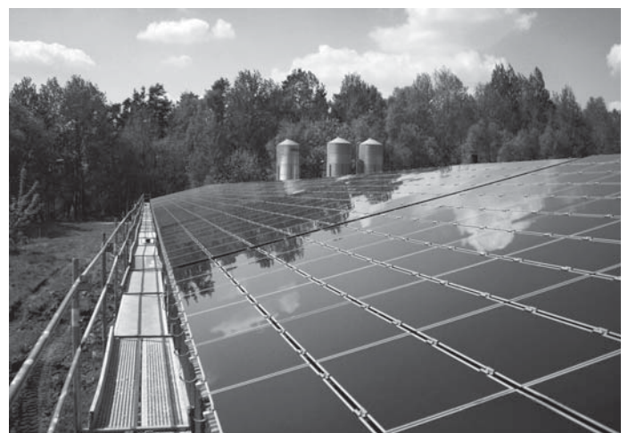
3,04 MWp Dünnschicht-Solarstromanlage auf den Dächern einer Geflügel-farm in Waldeck Foto: COLEXON Energy AG
