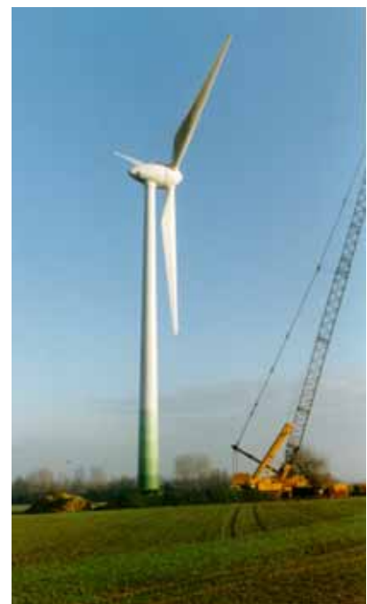
Bisher steht im Aachener „Windpark“ nur ein einziges Windrad (1,5 MW-Enercon der ASEAG)
